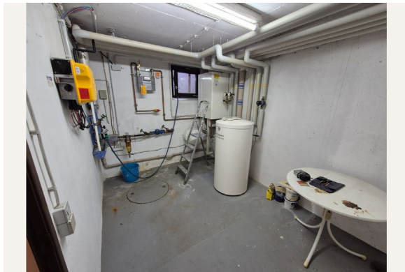
Heizungs- und Technikraum im Überblick
