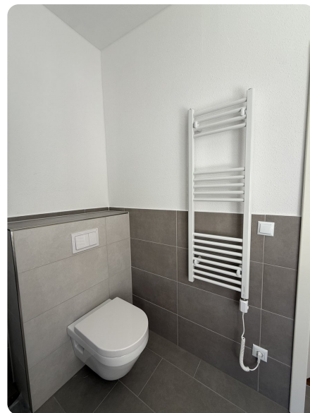
Wandhängendes WC, Handtuchheizkörper
