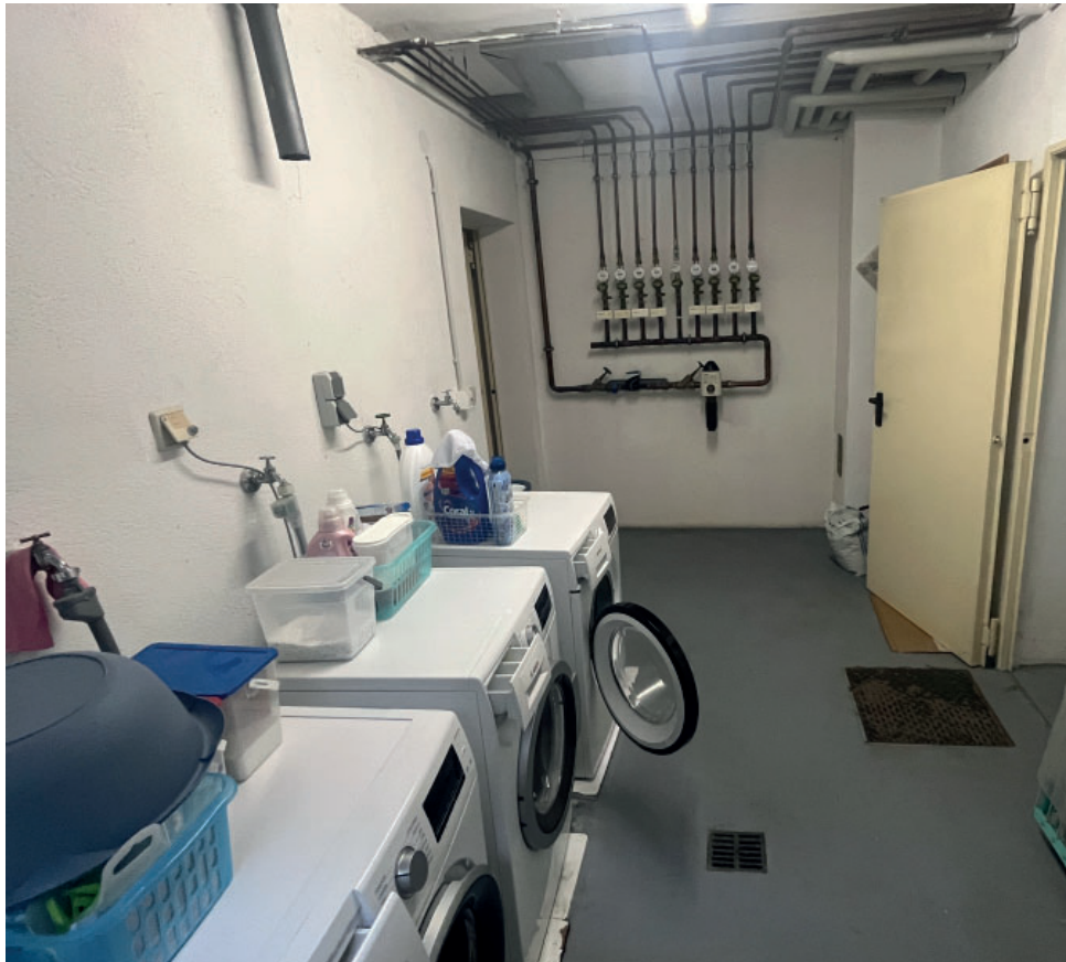
Keller mit Waschraum und Zähler
