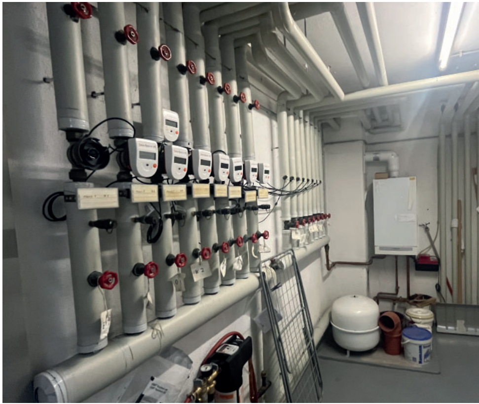
Keller mit Heizung und Zähler
