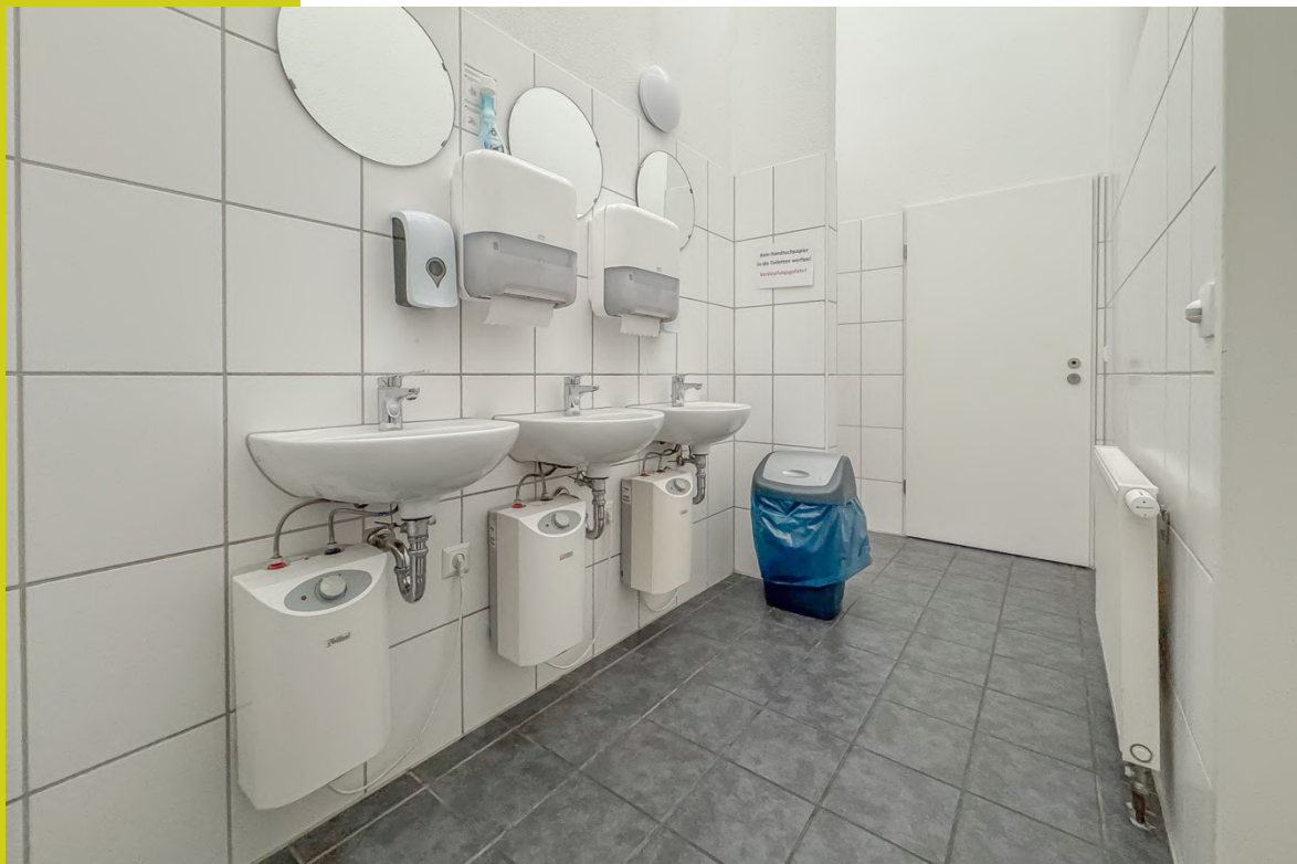
WC-Anlagen (mehrfache wöchentliche Reinigung!)
