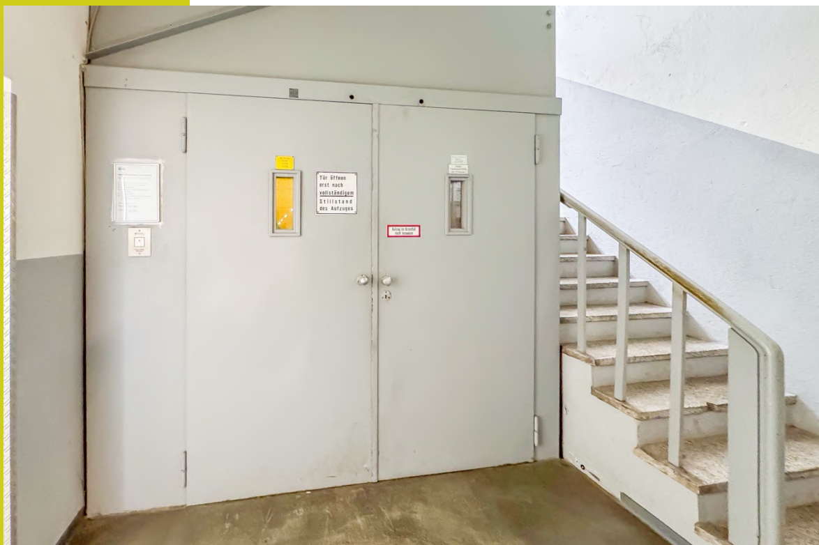
Lastenaufzug (bis zu 2 Tonnen Tragkraft)
