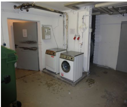
Wasch-/Trockenmaschinen Eingang oben / Balkon unten
