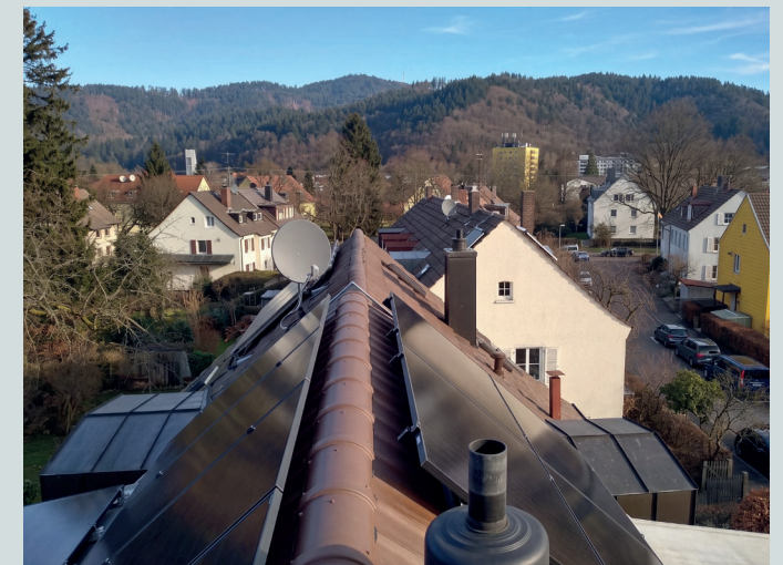
Vollsaniertes Dach mit PV-Anlage
