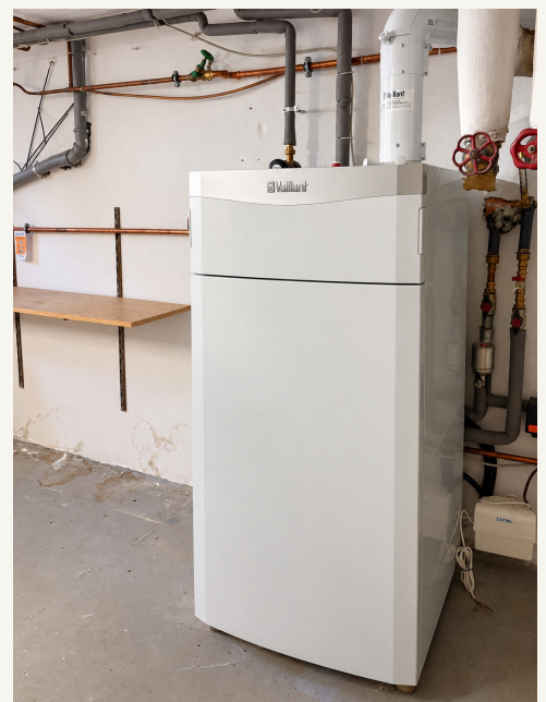
Gasheizung im Keller.
