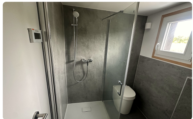
Bodengleiche Dusche mit Glasabtrennung.
