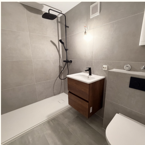
Modernes Bad mit flacher Dusche und hochwertigen Armaturen
