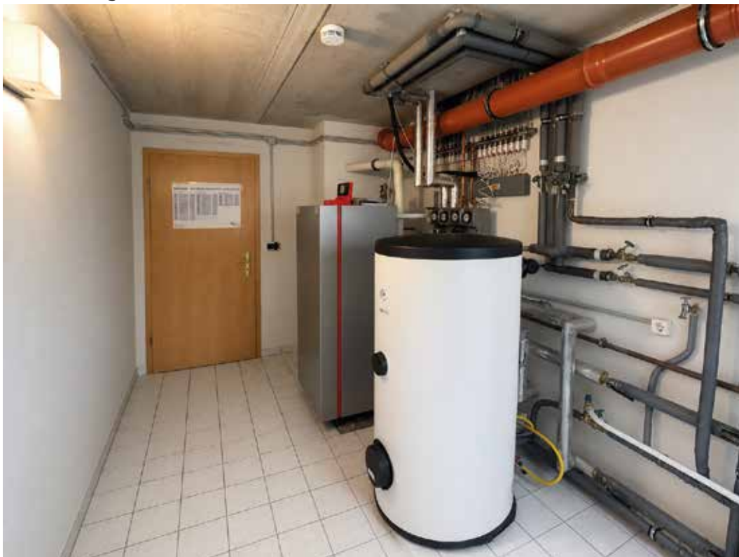
hier wird auch des Warmwasser für das gesamte Haus erzeugt, ideal zum Wäsche trocknen
