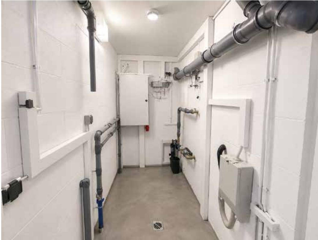
die Ver- und Entsorgungszentrale
