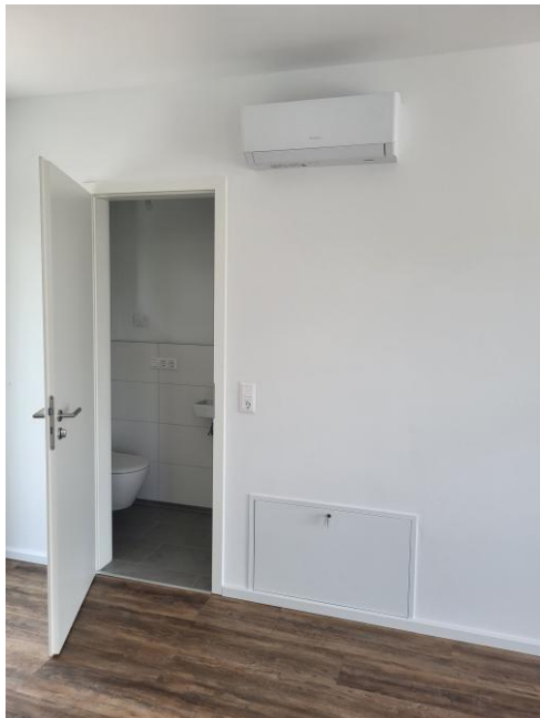
Klimaanlage im Dachgeschoss
