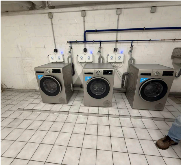
Waschmaschinen (W1–W3) mit App-Steuerung
