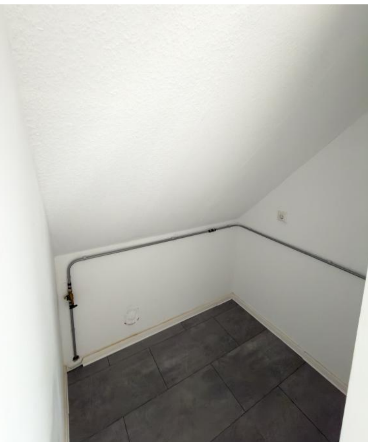
ABSTELLPLATZ BADEZIMMER FÜR WASCHMASCHINE UND TROCKNER
