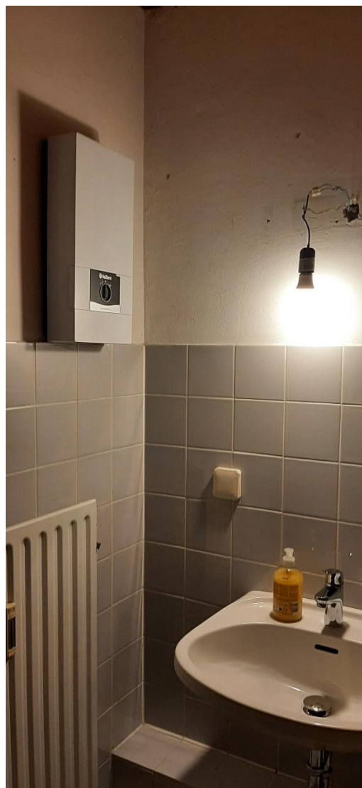
Bad, neuer Vaillant Durchlauferhitzer und Grohe Waschtischarmatur
