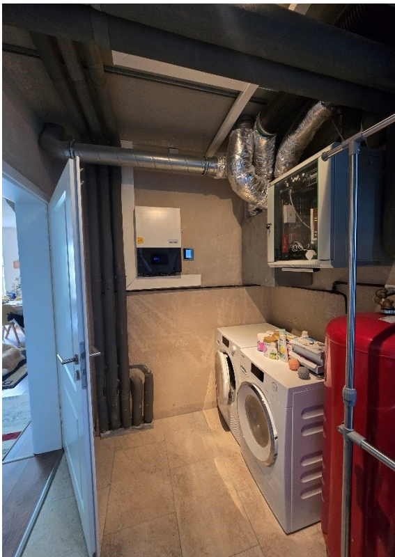
Hauswirtschaftsraum mit Anschluss für Waschmaschine und Trockner.
