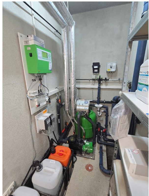
Poolgeräteraum (befindet sich in der Garage).
