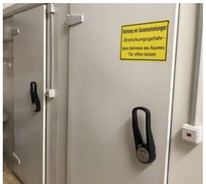
Direkte Zugang: Zwei geräumige Kühlhäuser
