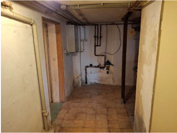
Flur Richtung Straße + altes Treppenhaus → Hausanschlüsse Wasser + Gas
