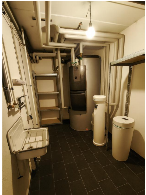
Technikraum & Übergabestation Nahwärmekraftwerk Untergeschoss
