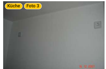
rechte Wand: Steckdosen im obere Bereich
