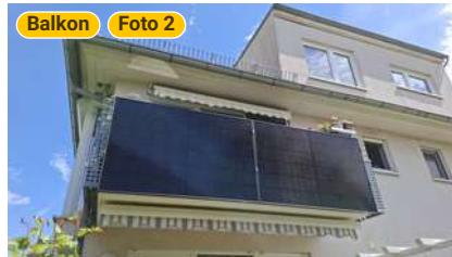
Balkon-Photovoltaikanlage (10.05.2024: Montage/ Inbetriebnahme/Funktionstests durch Firma Heimpower GmbH, Hufelandstraße 13a, 01...
