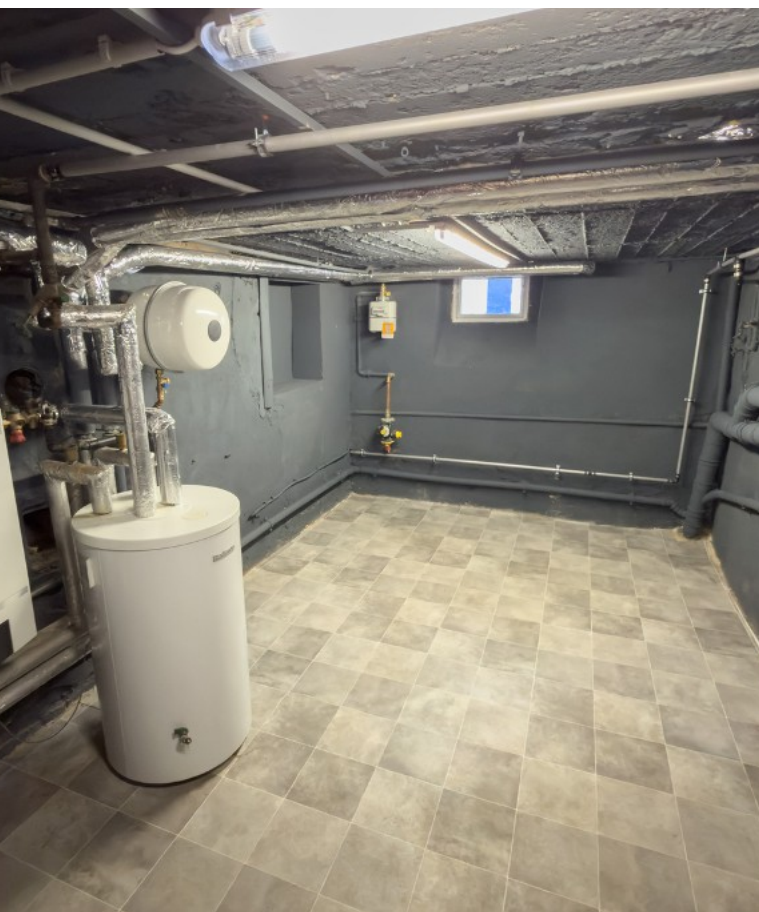
KELLER-HEIZUNGSRAUM DES HAUSES
