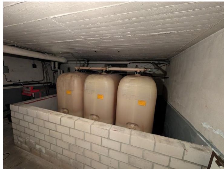
Foto B 4: KG-Öltanks
