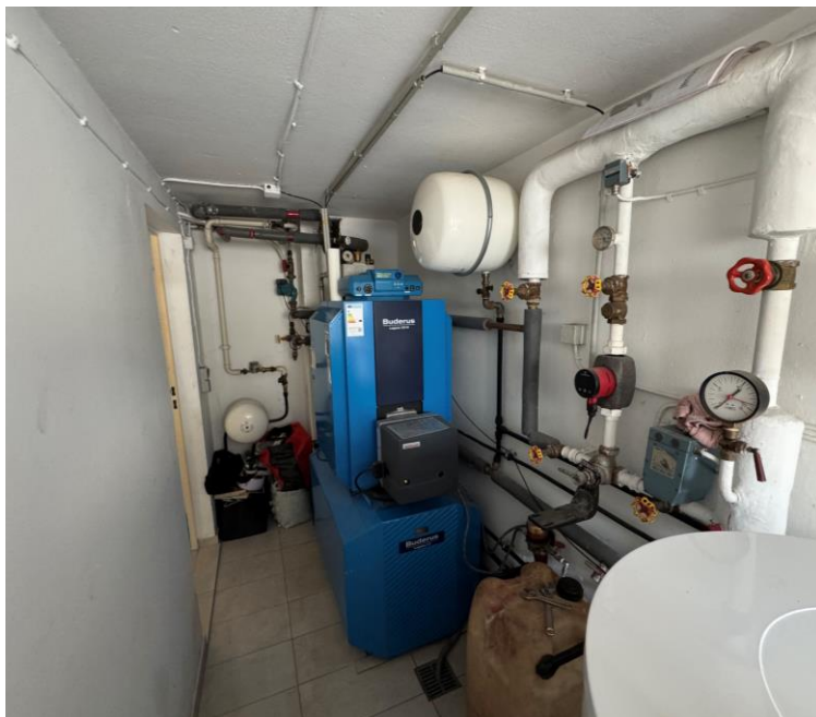
Technikraum | Innerhalb Souterrain Wohnung
