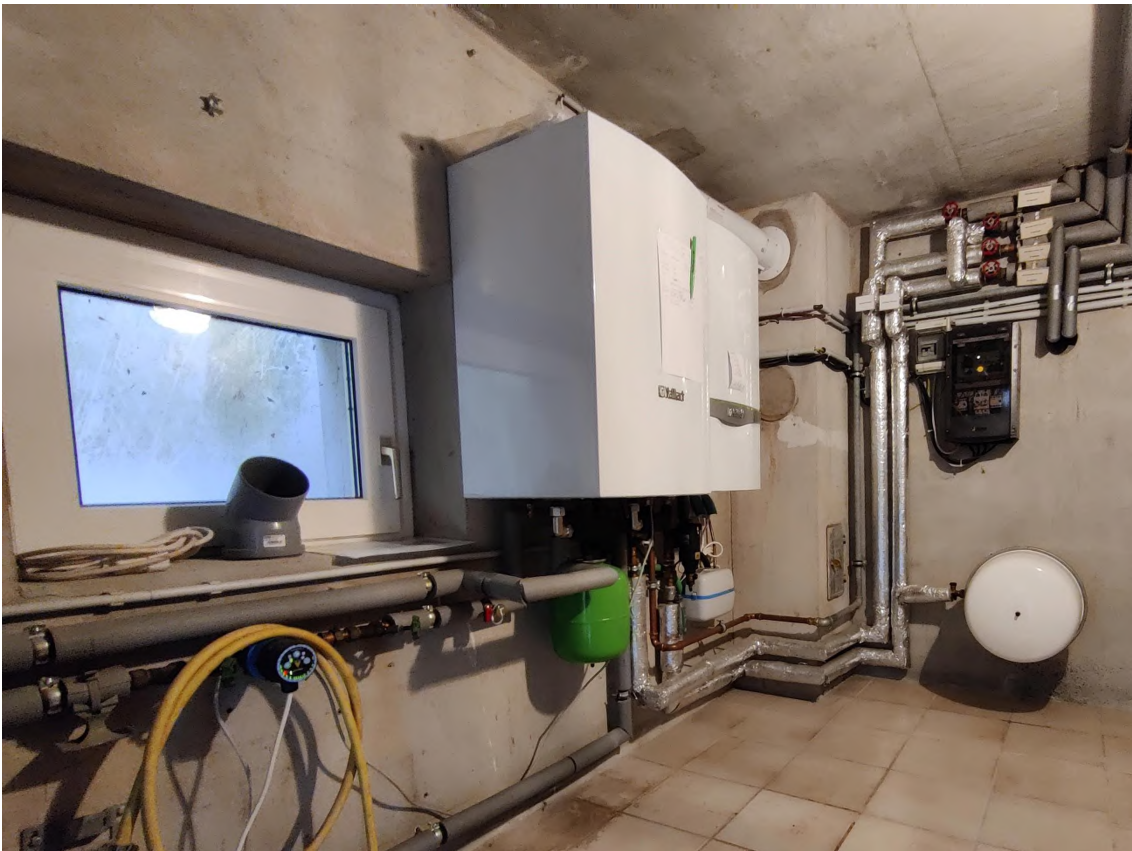
Moderne Heizung (Erdgas), erneuert 2016
