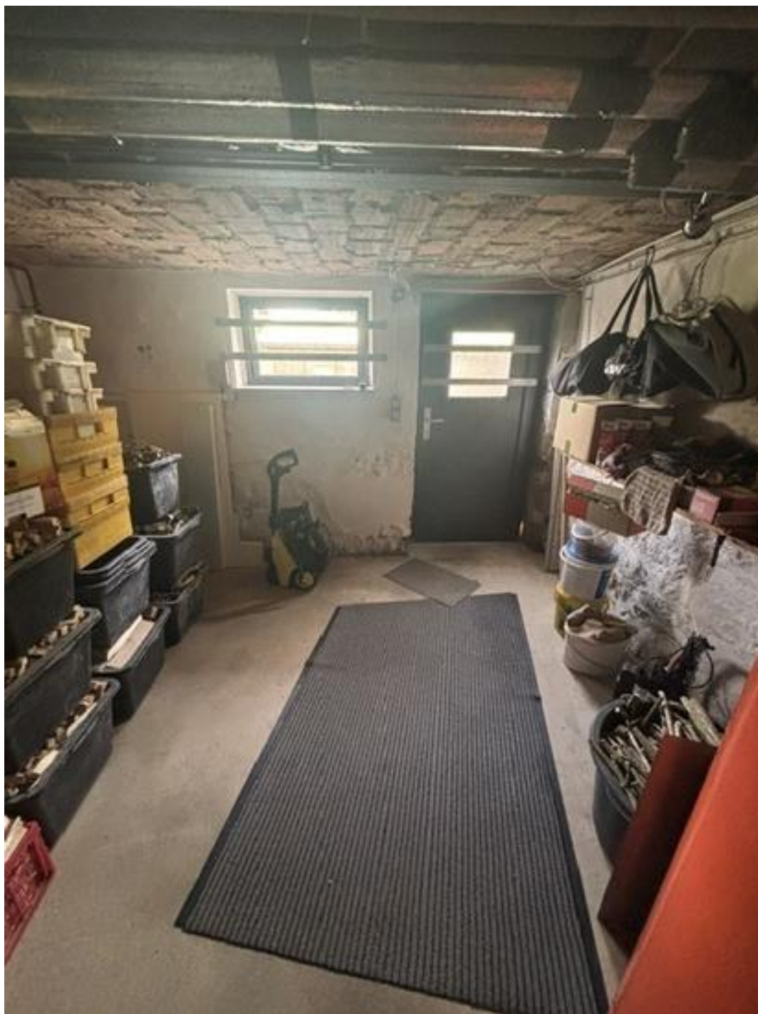
Bild 51 - Kellerraum, Außentür, Putzschäden
