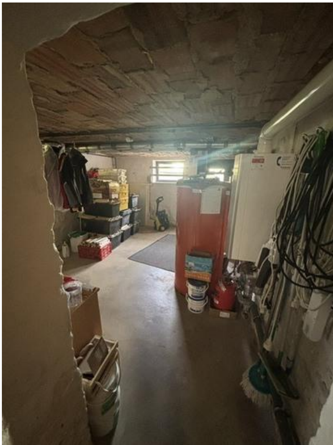
Bild 55 - Heizraum, Haustechnik, Durchgang
