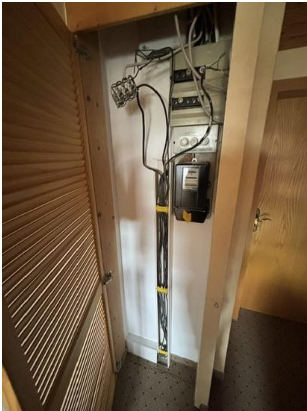
Bild 32 - Elektroverteilung, Zählerplatz, Einligerwohnung, OG
