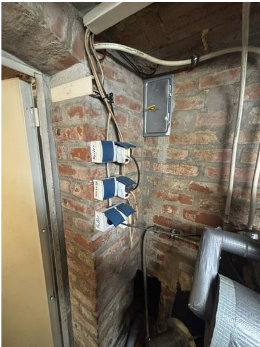
Bild 57 - Elektroinstallation, CEE-Steckdosen, Keller
