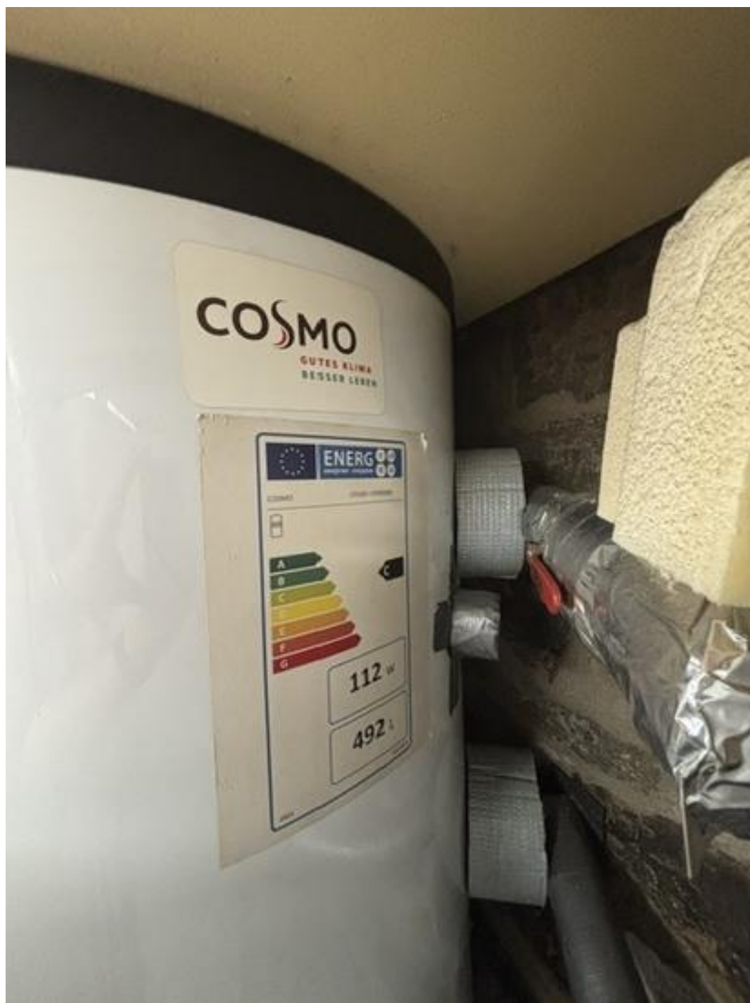
Bild 58 - Warmwasserspeicher, Typenschild, Technikraum
