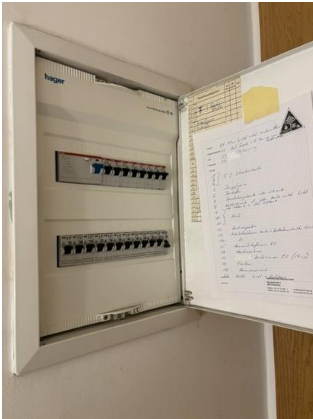
Bild 43 - Elektroverteiler, Sicherungen, Beschriftung
