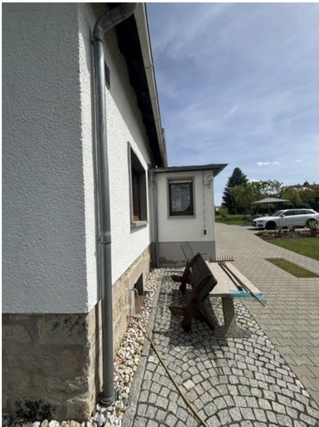
Bild 5 - Fassade Seitenansicht, Sockelbereich, Fallrohr, Wegefläche
