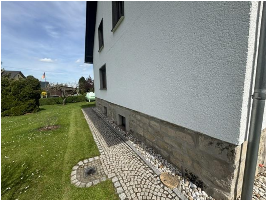
Bild 10 - Fassade Seitenansicht, Sockelbereich, Traufpflaster, Entwässerung
