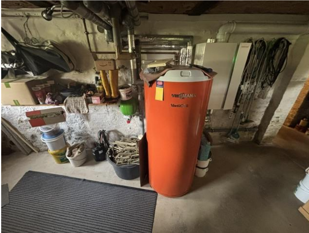
Bild 56 - Technikraum, Warmwasserspeicher, Heizungsanlage
