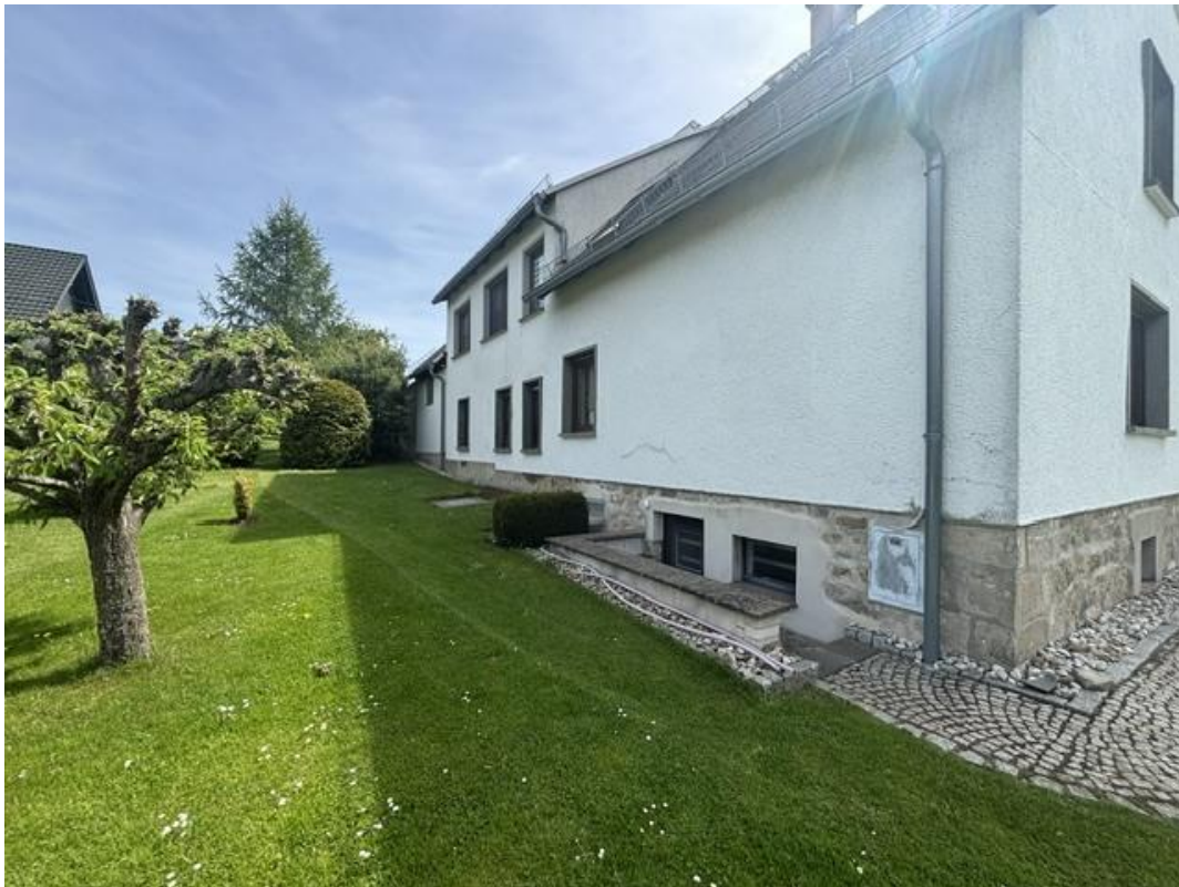
Bild 14 - Seitenansicht, Fassade, Sockelbereich, Rissbildung
