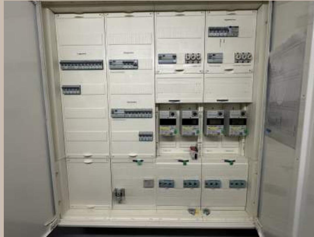
Haustechnik - Heizung - Wärmepumpe
