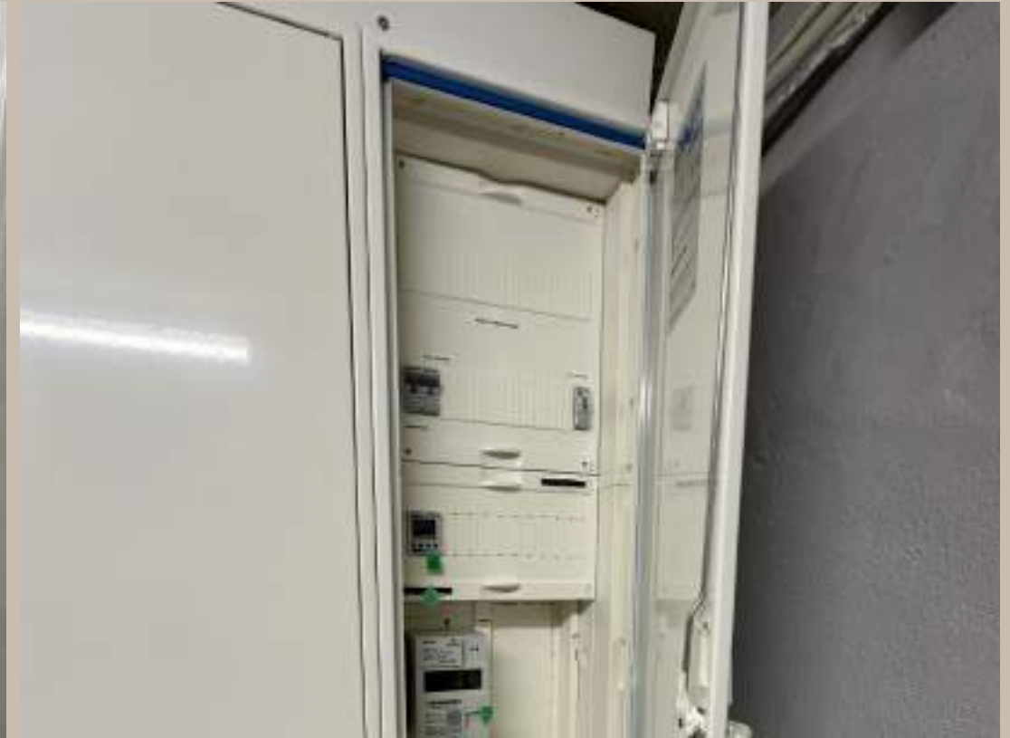
Haustechnik - Heizung - Wärmepumpe
