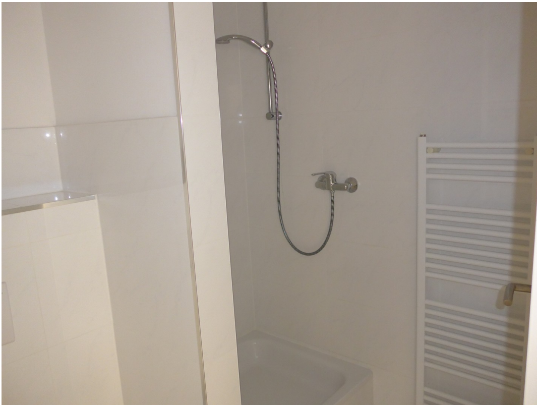
Duschbad und Handtuch-Heizung
