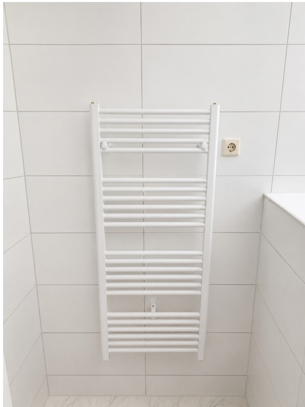
Bade Zimmer Heizung
