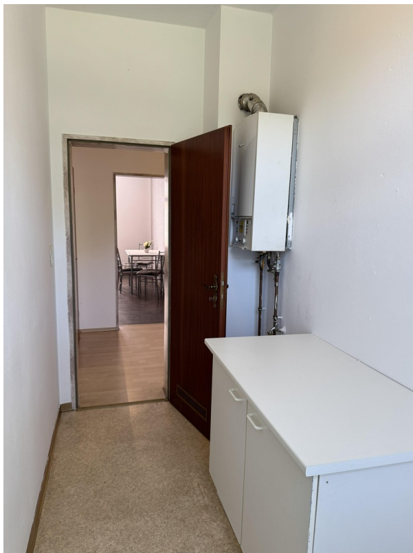
Abstellraum mit Therme
