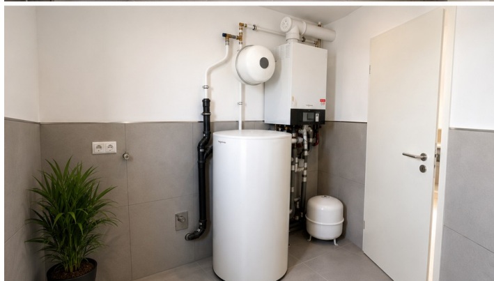
Gäste WC / Heizung
