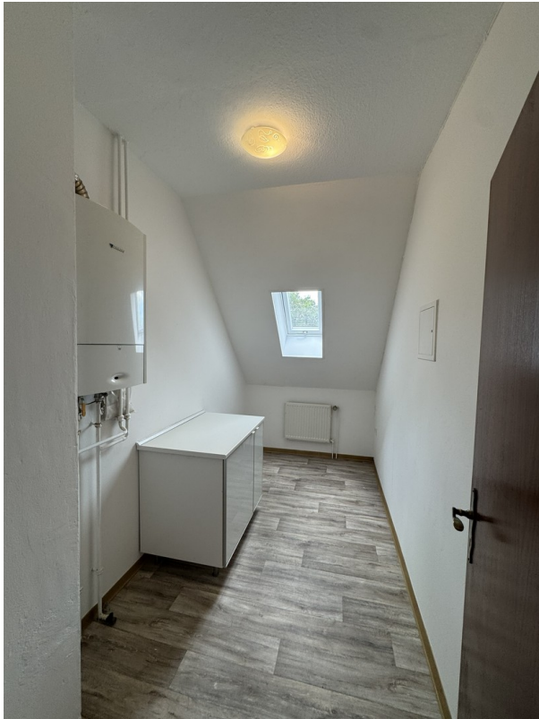
Abstellraum mit Therme
