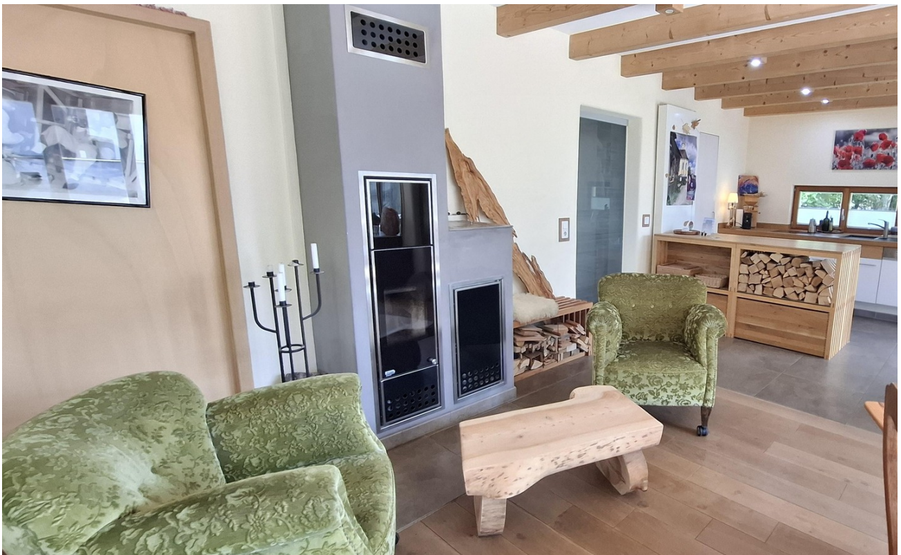
EG Wohnen Heizung
