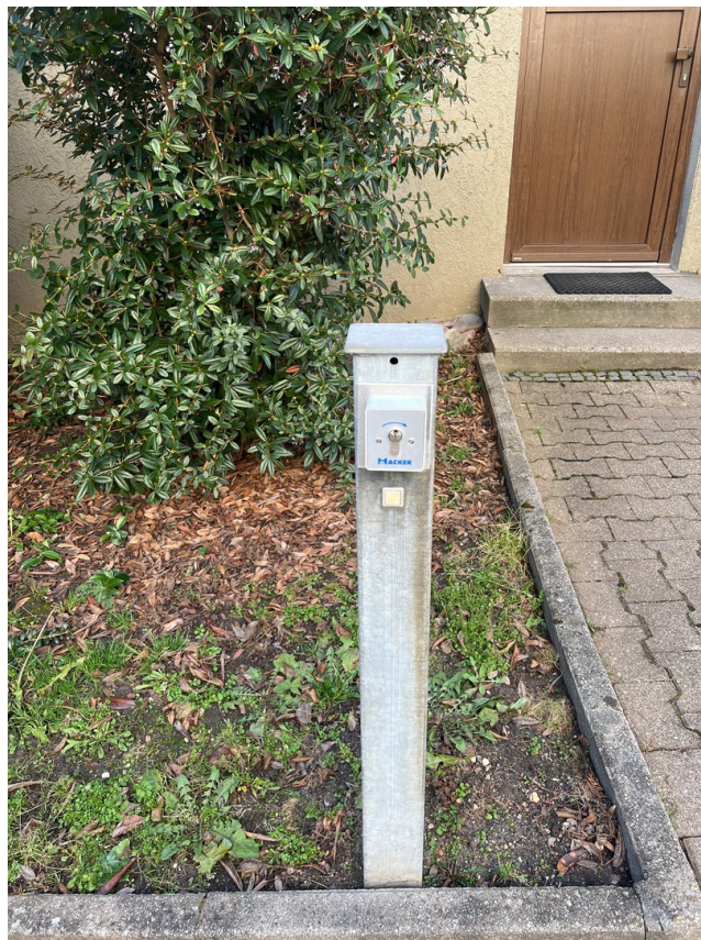
Elektr. Schließsystem Garage
