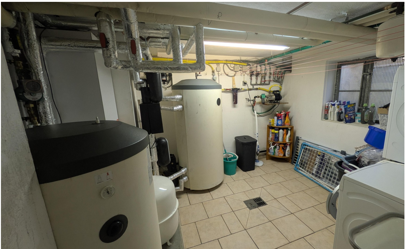
Heizungsraum und Waschküche
