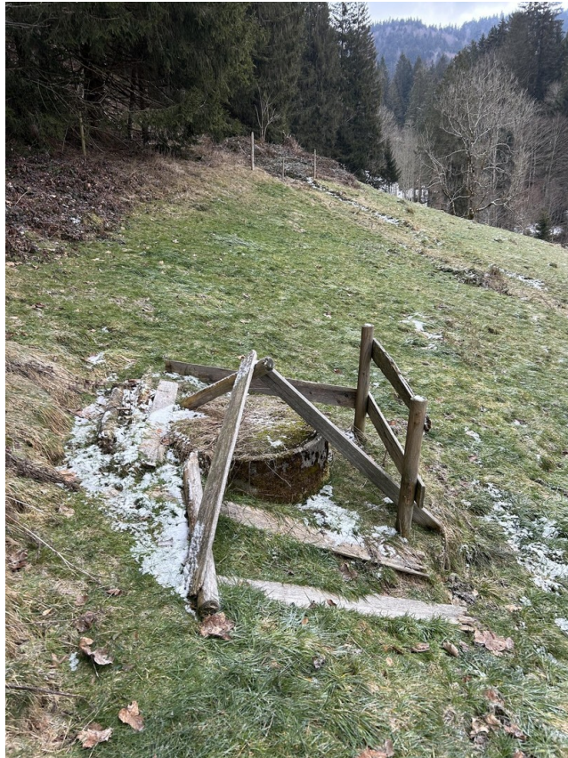
Quellschacht am Hang
