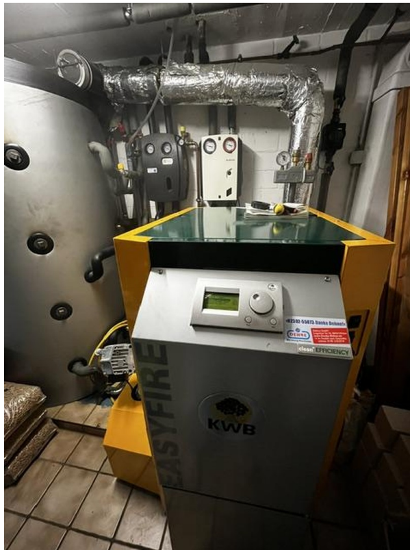
Pellet Heizung Keller
