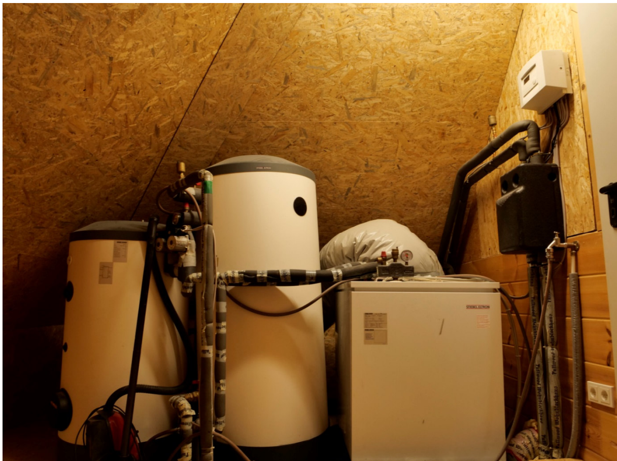
Wärmepumpe und Warmwasserspeicher
