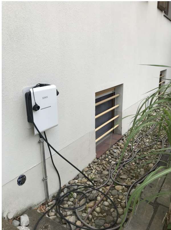
Wallbox an der Fassade
