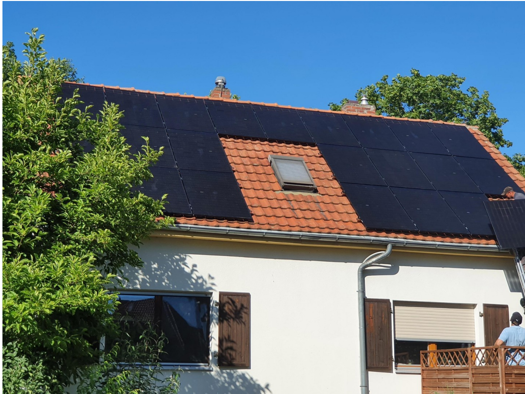
Satteldach mit Solar
