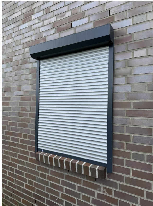
elektr. Rollläden EG gesamt
