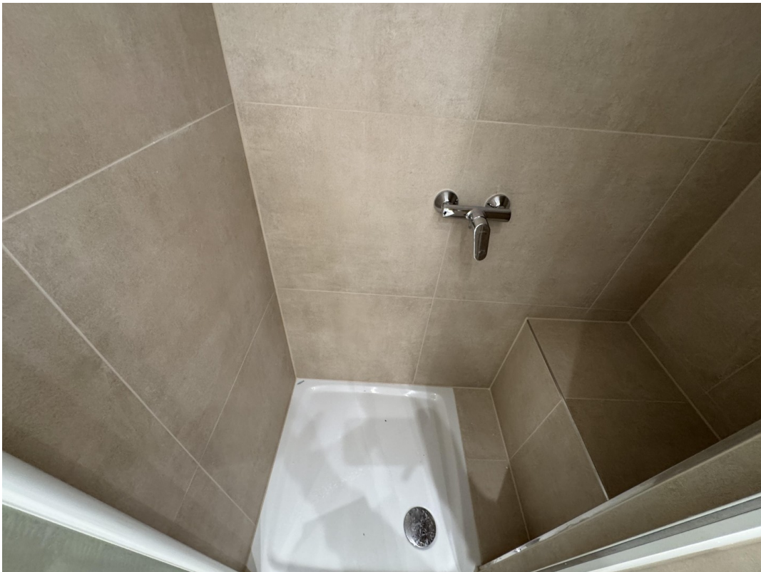
Dusche mit Ablage
