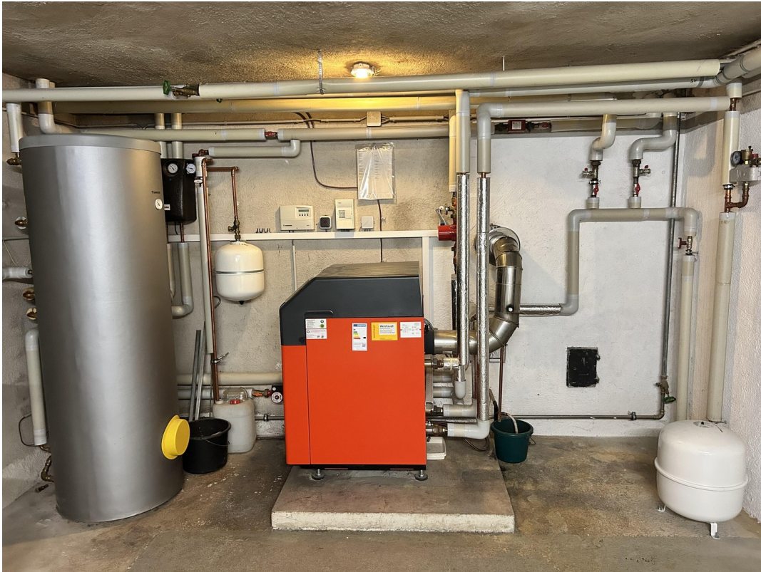
UG - Keller 2 Ölheizung/Solar
