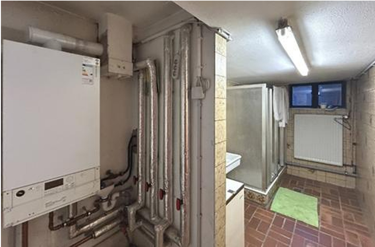
Dusche / Heizung UG
