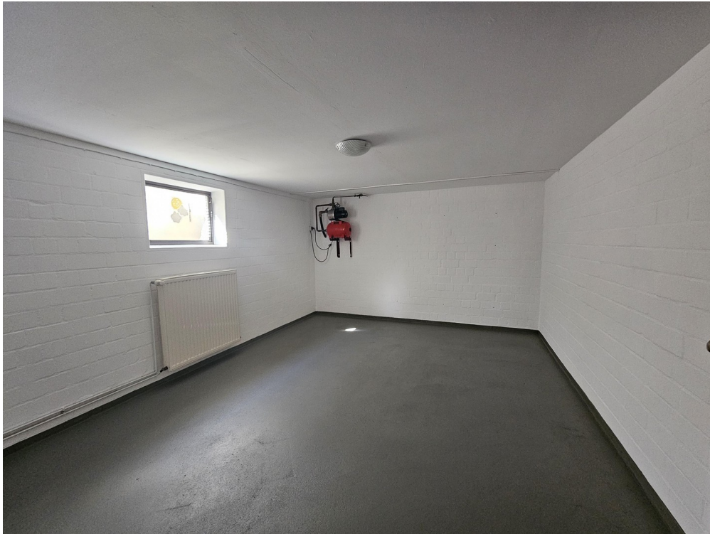
Kellerraum mit Pumpe
