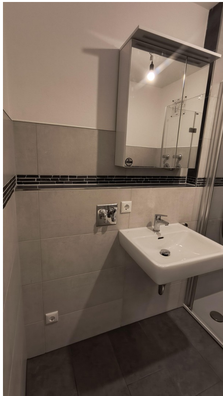
Waschmaschinenanschluss im Bad
