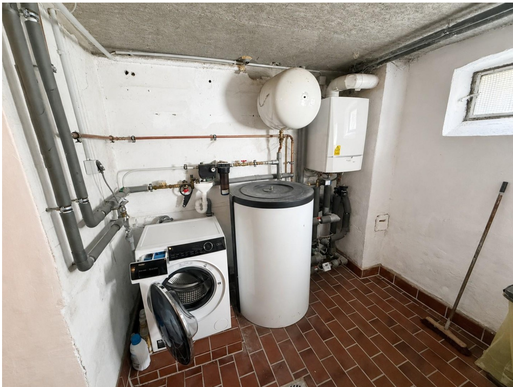
KG Waschküche Heizung
