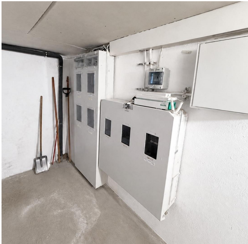
KG Zählerschränke Elektrik
