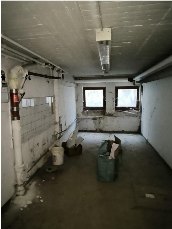
Raum mit Küchenanschlüssen
