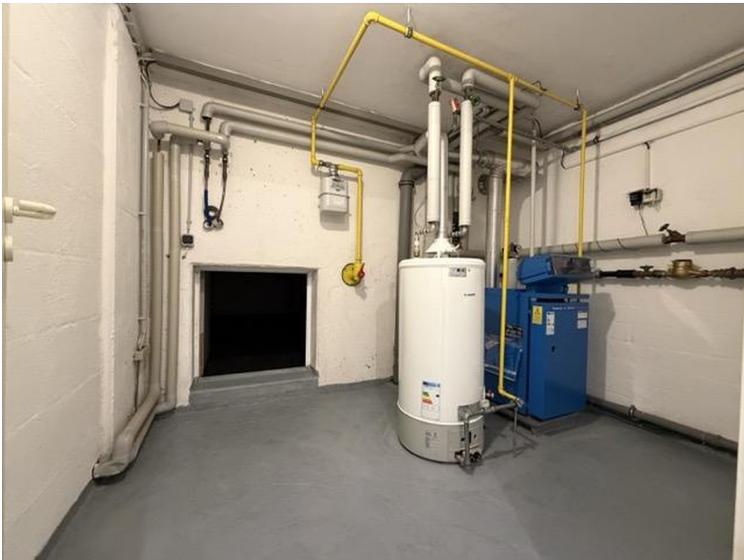
1c_Keller Heizung & Boiler
