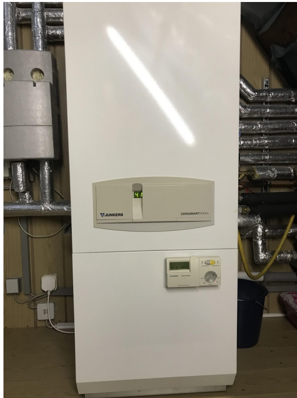
Heizung Junkers im Spitzdach
