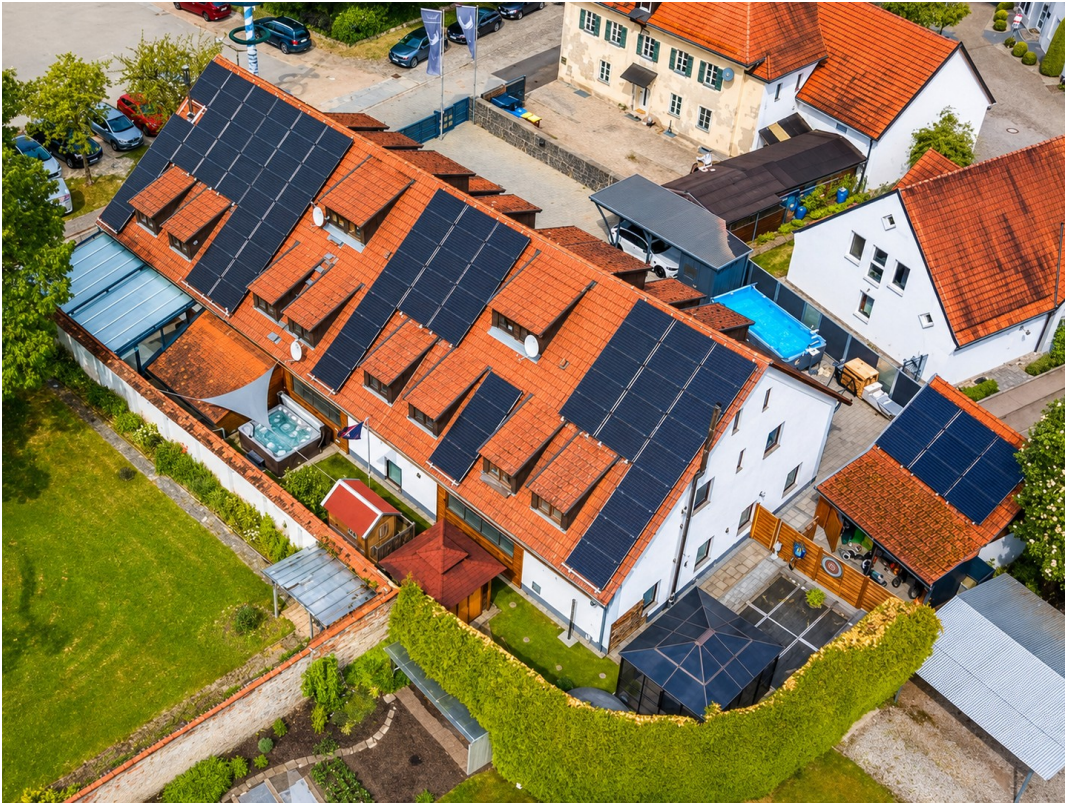
PV-Anlage mit 34kWh Speicher
