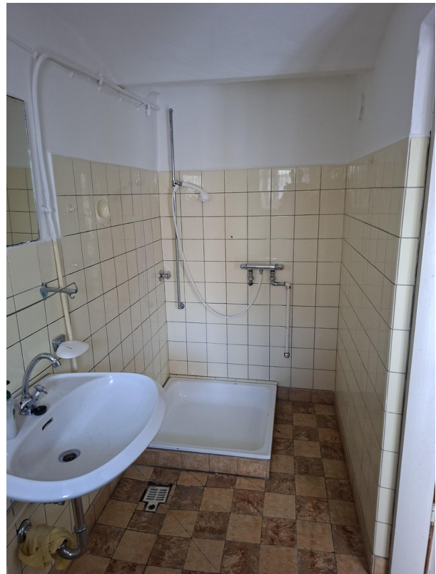
WC/Dusche EG Wohnung 1
