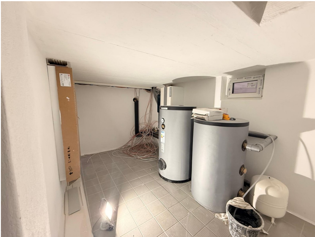
Kellerraum mit Technik
