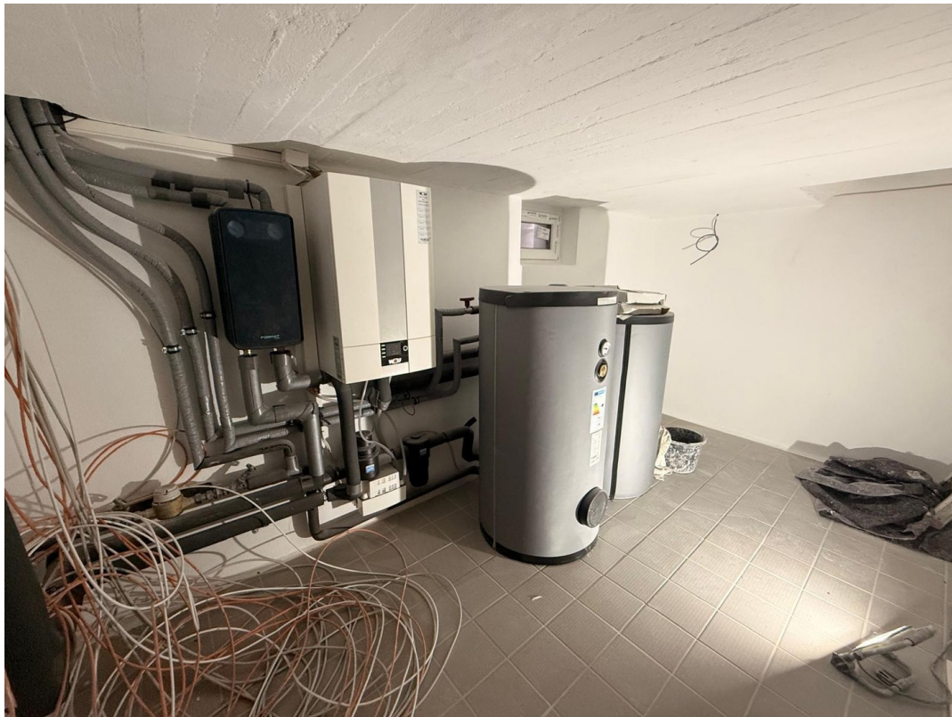
Wärmepumpe im Kellerraum
